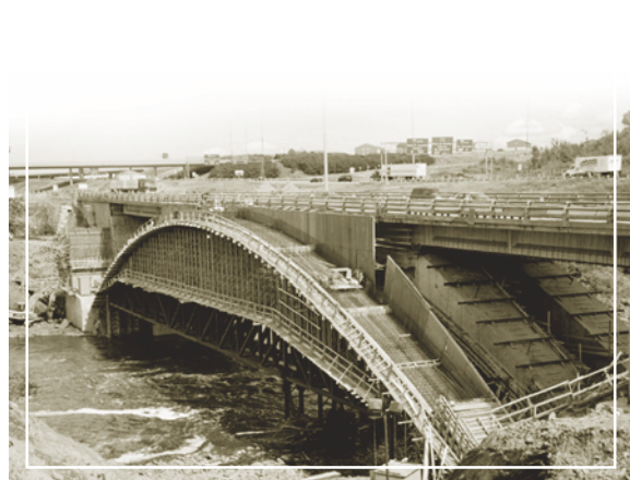
Travaux de conservation du pont arc à dalle raidie sur la rivière Chaudière.
